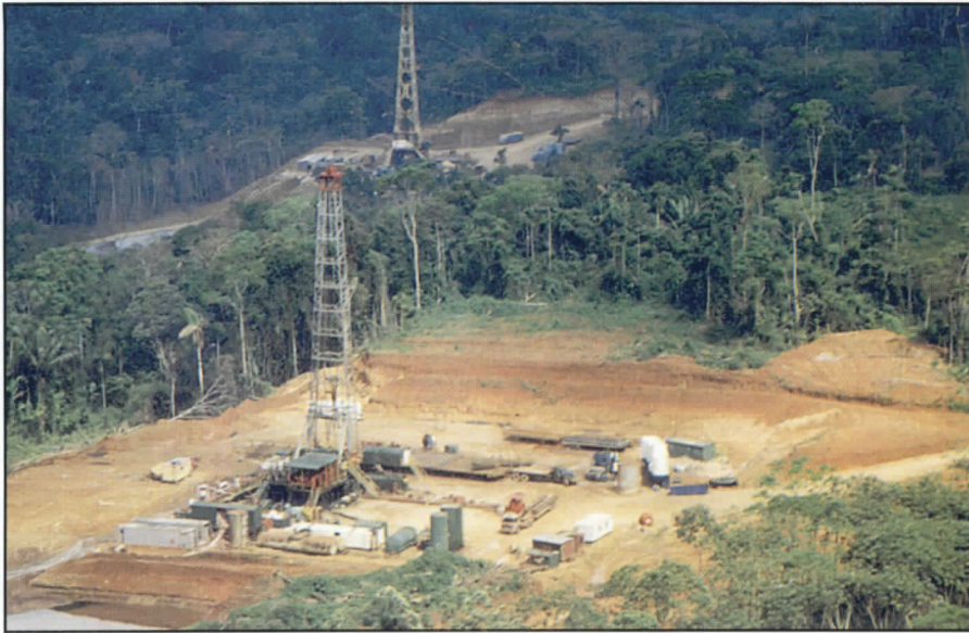
Torres de Perforación
