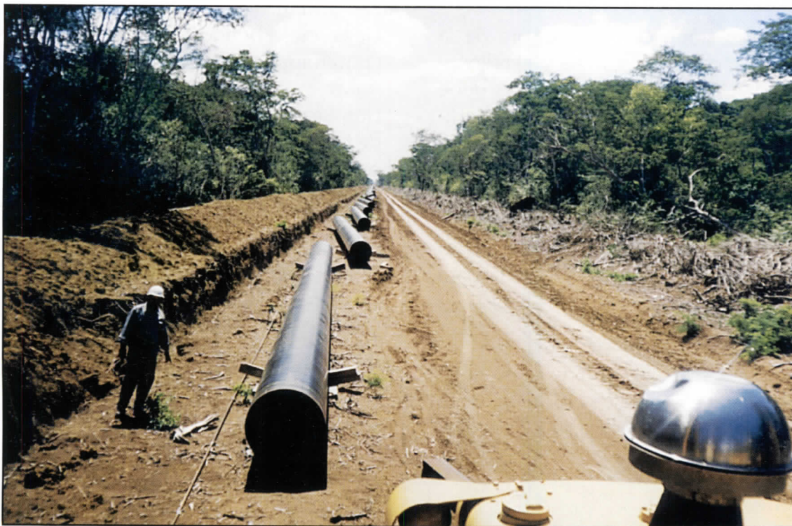
Foto del frente de trabajo (ancho de vía) en el tendido de la tubería del gasoducto al Brasil. En la misma puede identificarse el ancho del desbosque, la zanja, el camino paralelo de mantenimiento, la tubería, etc.
