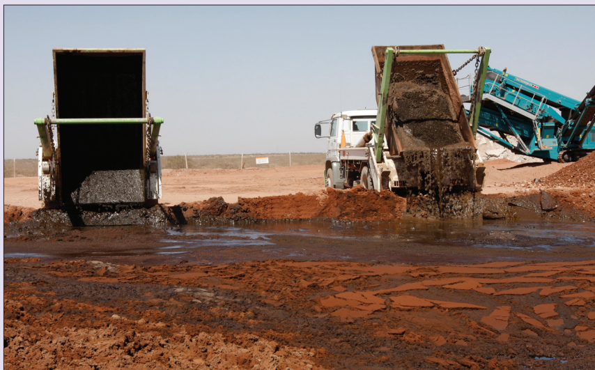
Contaminación por petróleo en Loma la Lata - Provincia de Neuquén
